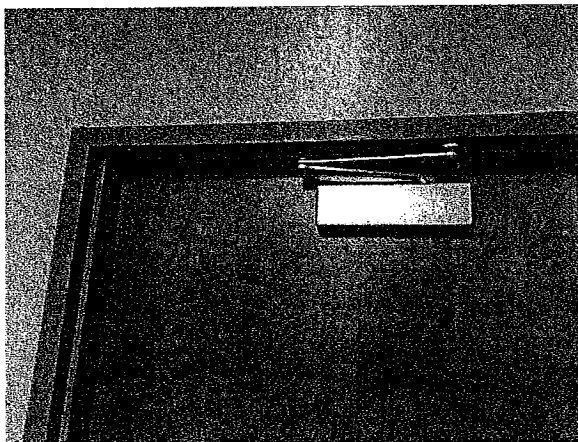
Photo 12 – Clean Door Frames.
